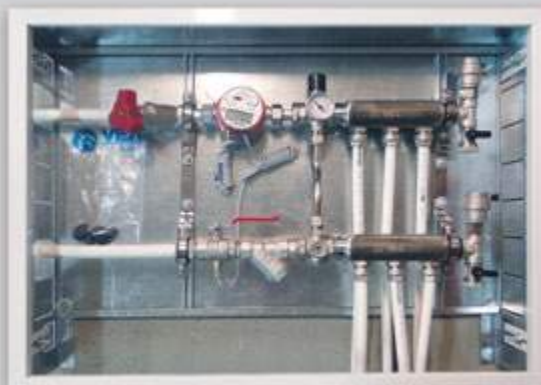
Рис. 22 Коллекторный шкаф с узлом учета и перепускным клапаном
