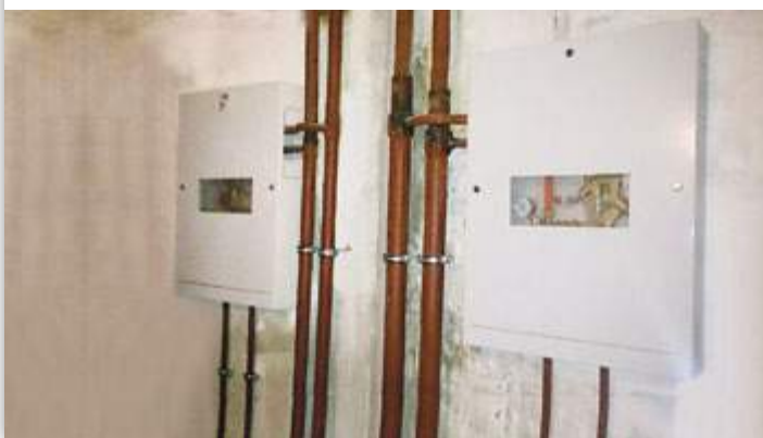
Рис. 24 Шкафные станции IV Control Modul на лестничной площадке строящегося многоквартирного дома
