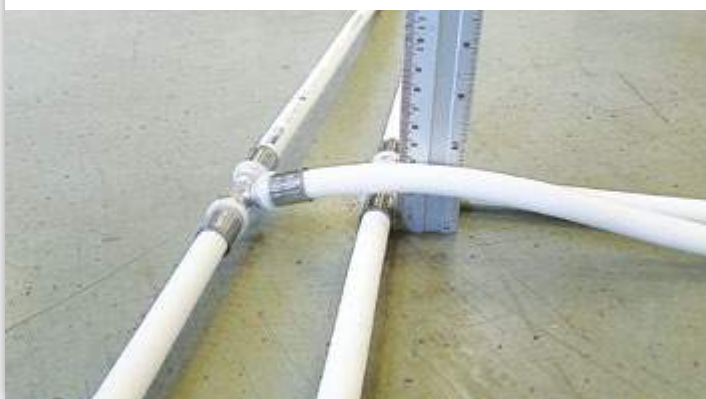
Рис. 5 Взаимное перекрещивание трубопроводов
