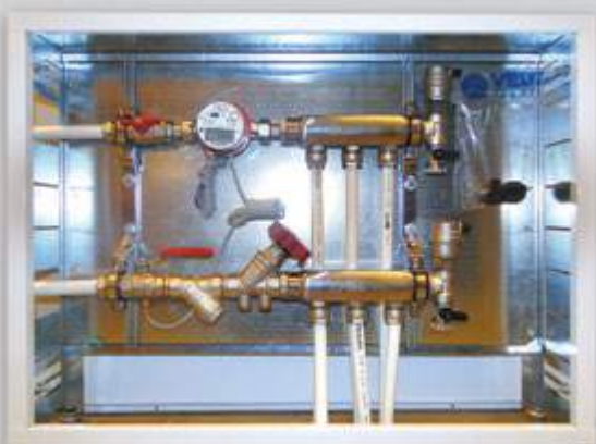
Рис. 21 Коллекторный шкаф с узлом учета тепловой энергии
