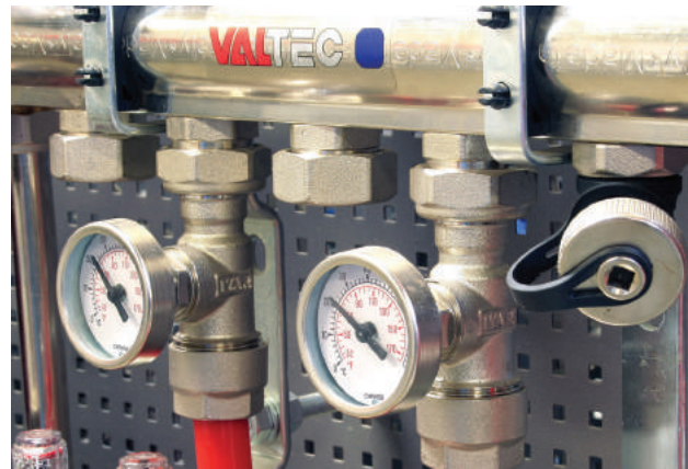
Рис.9 Термометр VT.4615 установленный перед коллектором
